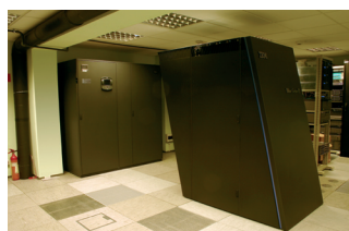
Procesory Notosa chłodzi powietrze. Następny superkomputer stanie w serwerowni ICM na jesieni i będzie chłodzony strumieniami zimnej wody.
